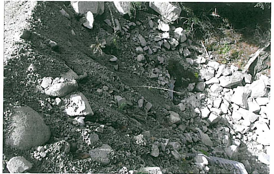
CK-2422 Outlet Fill
